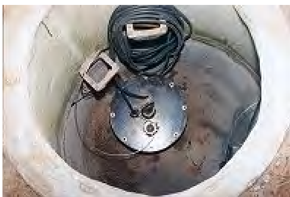
Шахта скважины (всасывающая скважина)
